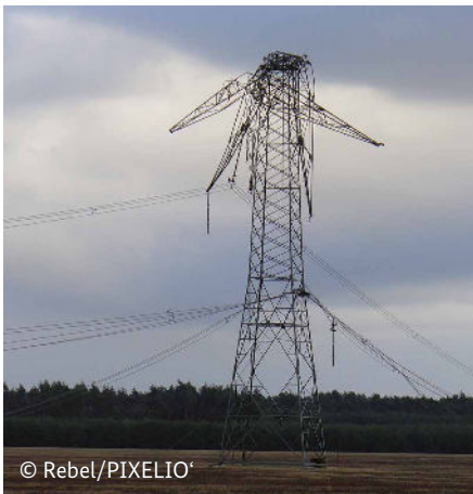
Sturmschaden durch den Orkan Kyrill im Jahr 2007
